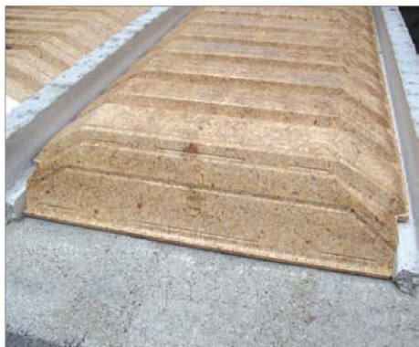
Pose de l'EBS en bout de travée avec bouchon incorporé. Toujours commencer par les extrémités avec les bouchons sur les arases
